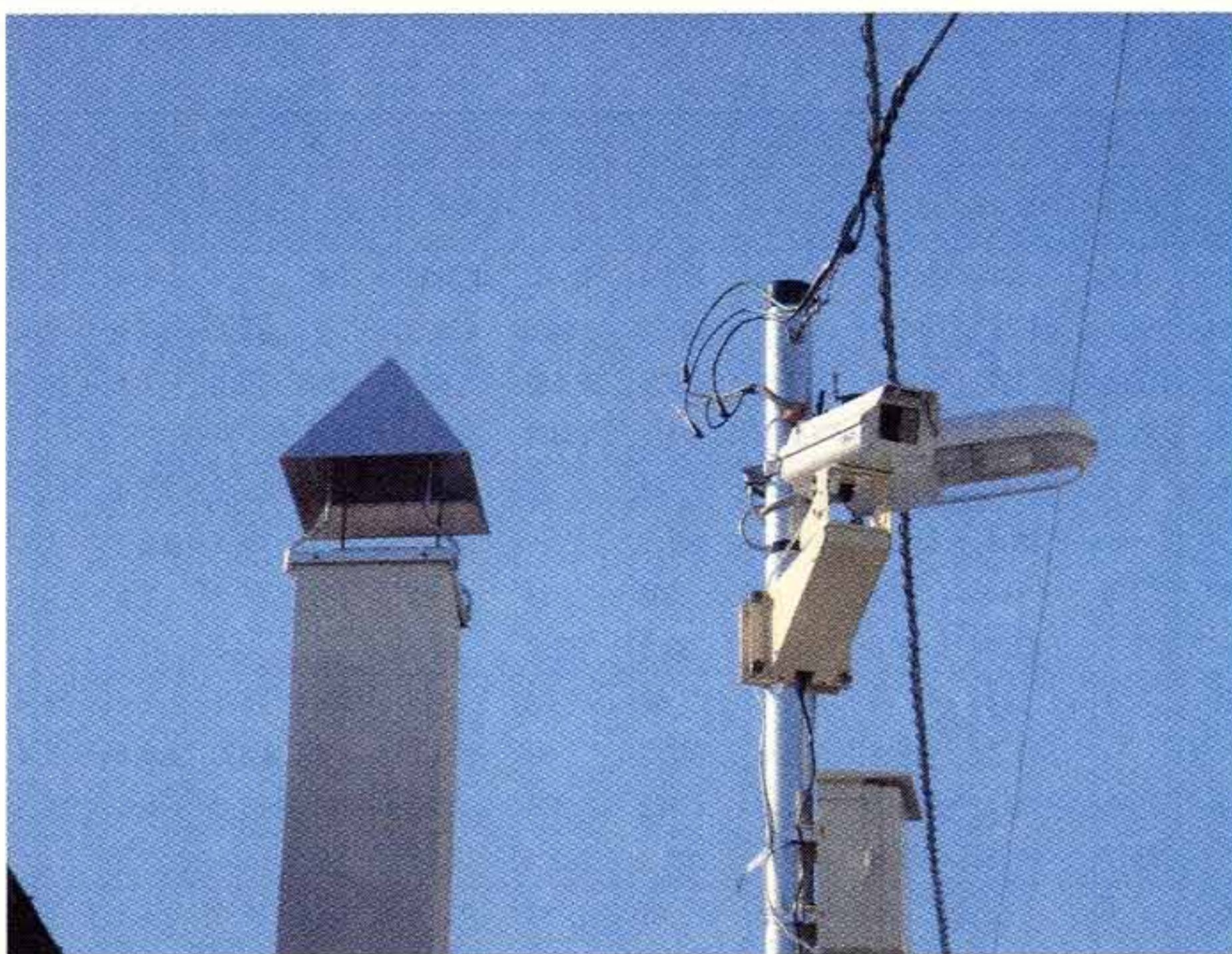
電気の臨時塔に取り付けたライブカメラ。防犯対策としてセンサー灯と一緒に設置している
